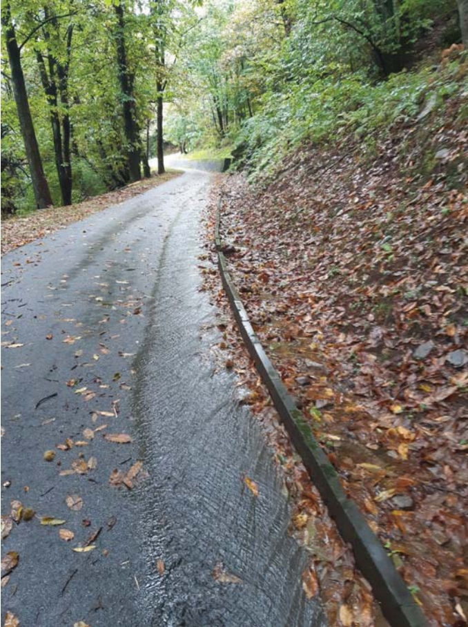
Foto 29 Venute d'acqua e bordure divelte
