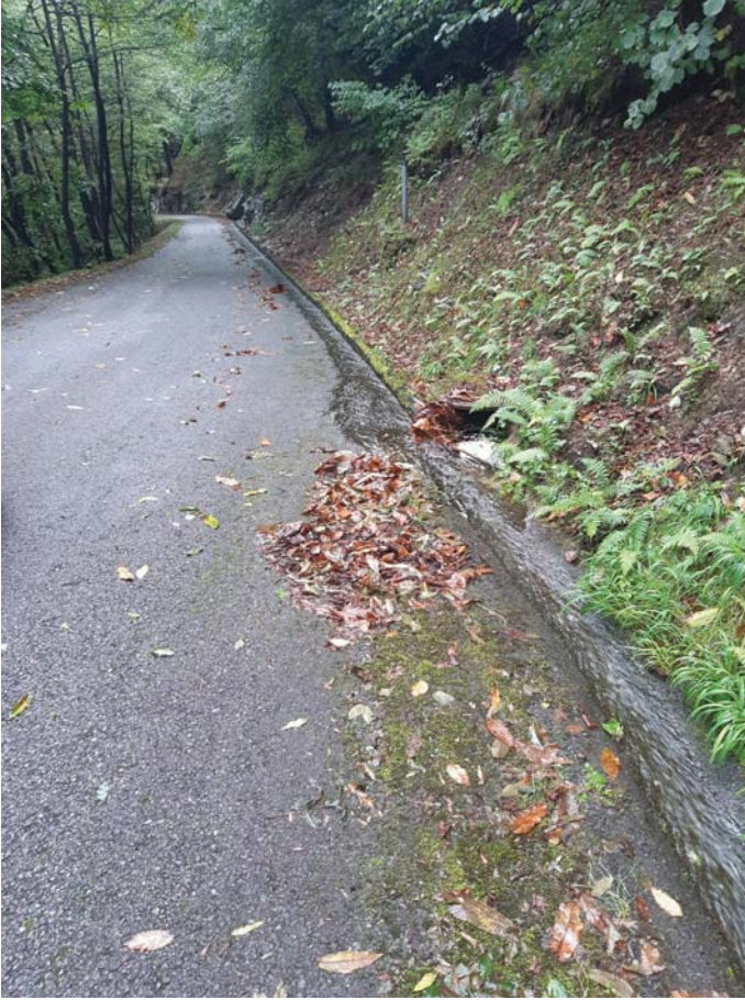
Foto 25 Intervento 2011, caditoia ostruita
