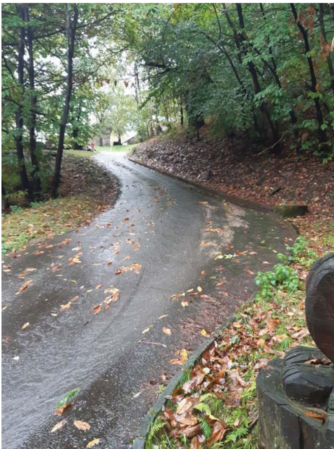
Foto 19 Acqua in strada proveniente dal sentiero Cassinei Intervento 6 con posa canaletta Ghisla
