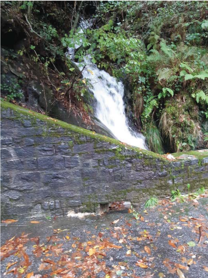
Foto 1 Tombinone sotto Pianturino con imbocco insufficiente - intervento 1
