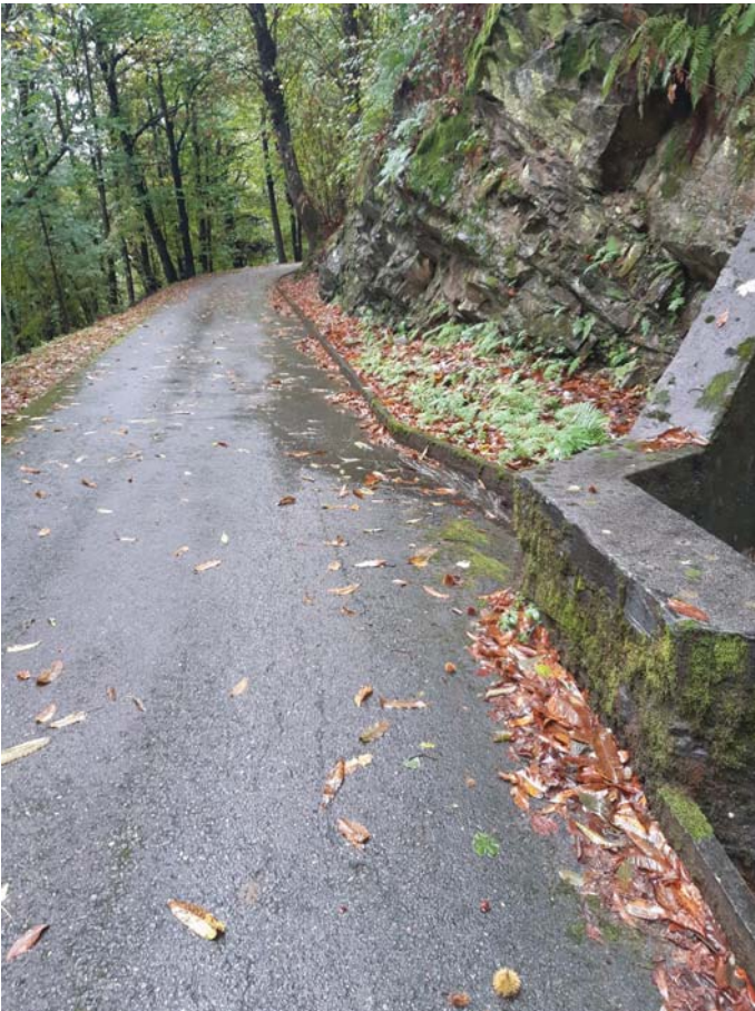
Foto 31 Acqua in strada e imbocco nel tombinone
