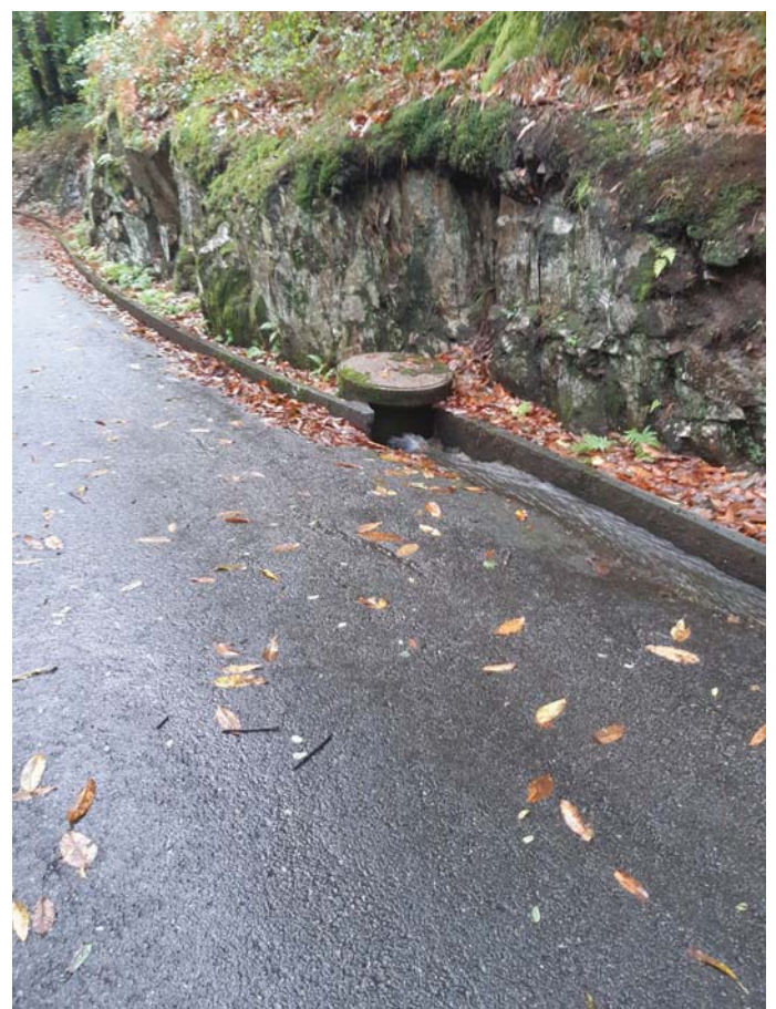
Foto 20 Acqua in strada proveniente dal sentiero Cassinei
