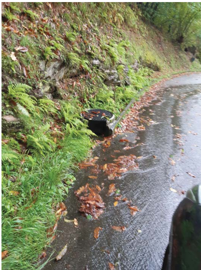
Foto 3 Caditoia "saltata" dall'acqua, intervento 2
