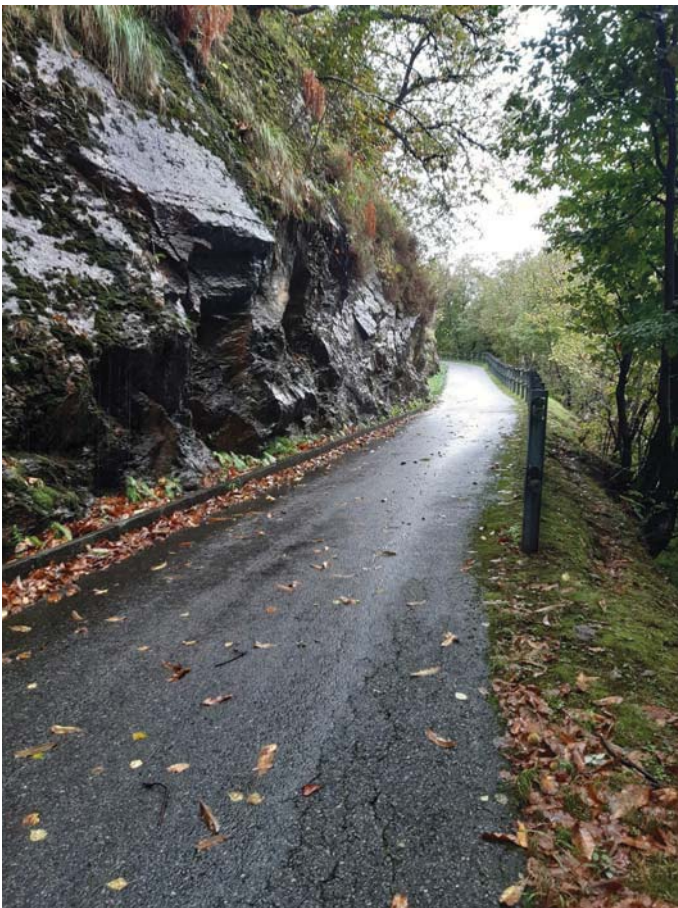
Foto 15 Strada con cedimento locale su ciglio valle
