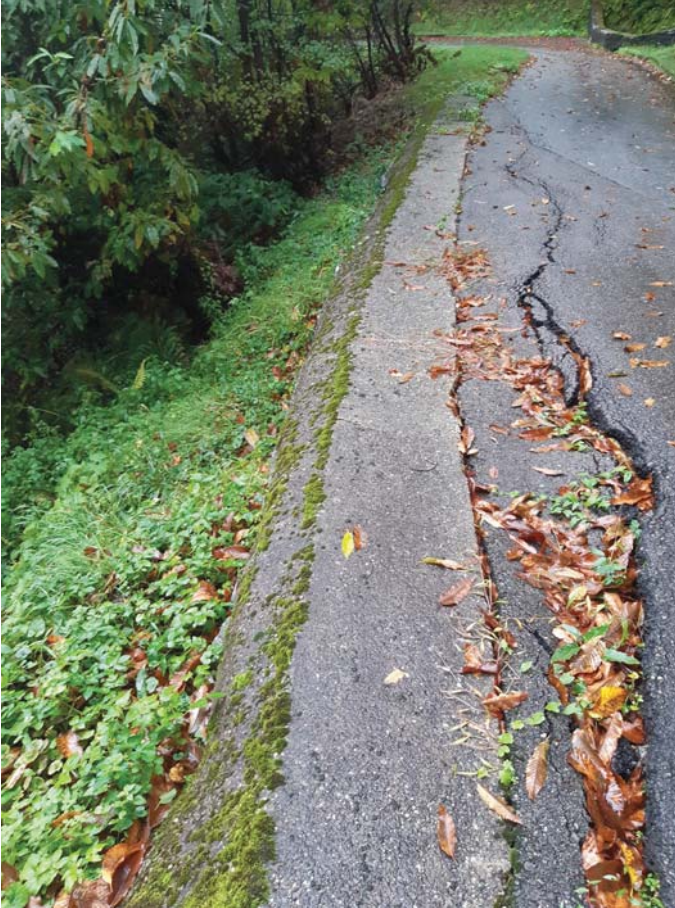
Foto 5 Cedimento bordo a valle della strada, Intervento 4
