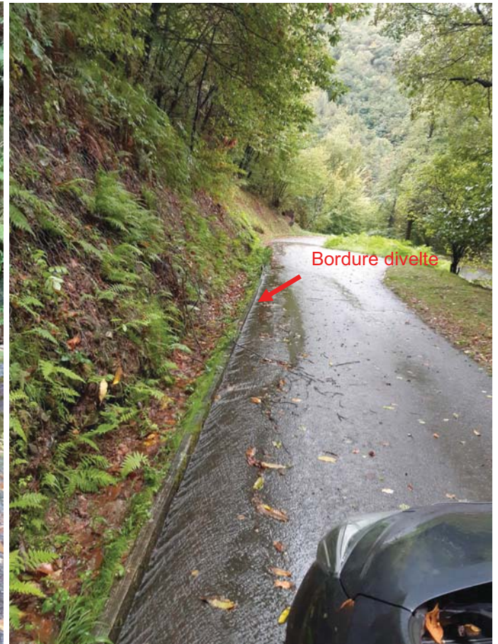
Foto 2 Scorrimento acqua sulla strada - intervento 2
