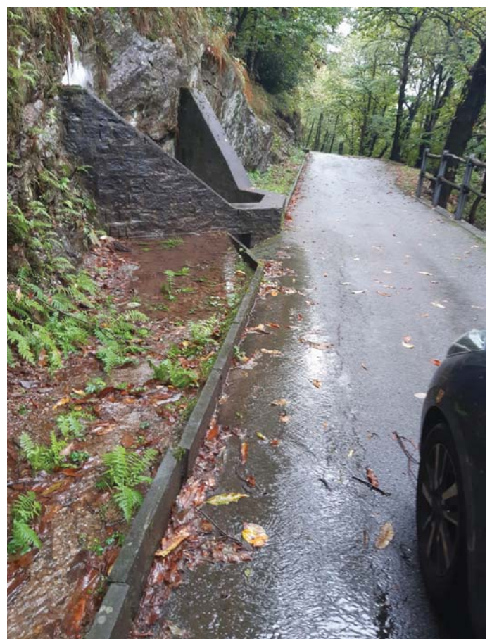
Foto 32 Tombinone con imbocco e bordure divelte
