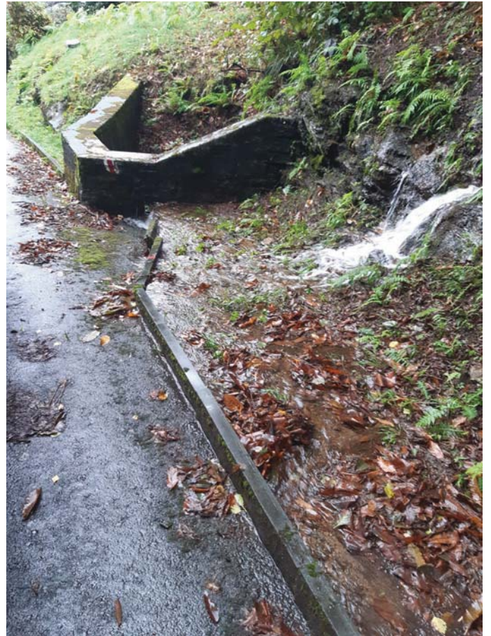
Foto 22 Fuoriuscita laterale da corso riale sopra Tombinone Intervento 7, pulizia riale sopra la strada manutenzione
