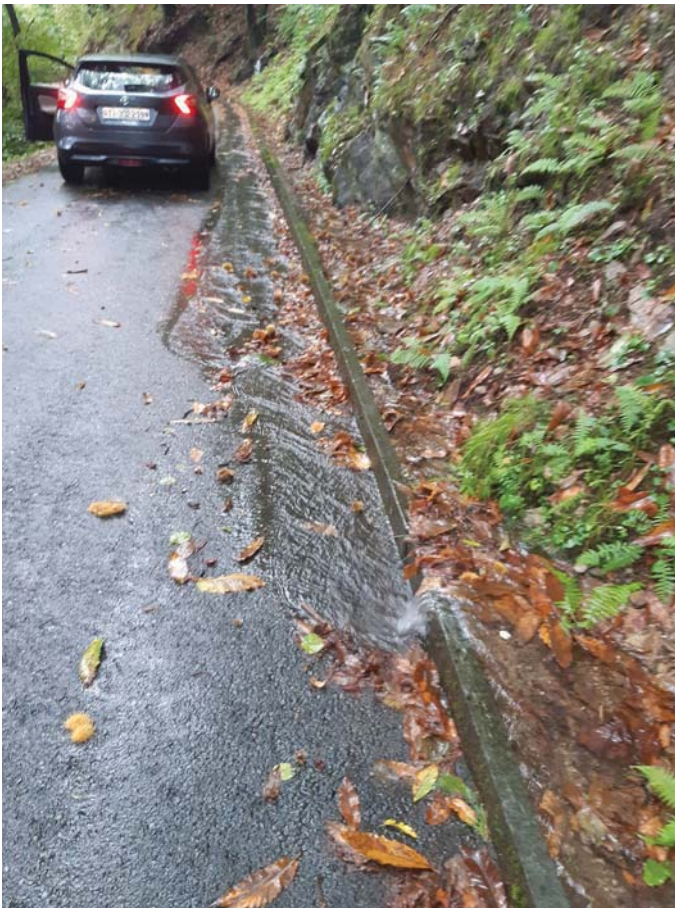
Foto 7 Acqua che scavalca la bordura e finisce in strada
